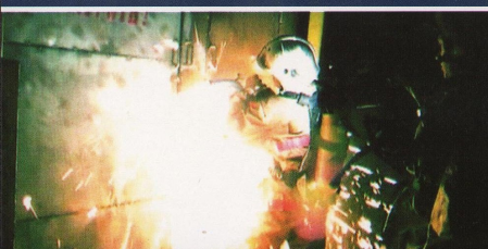
сварочные работы, окурки
